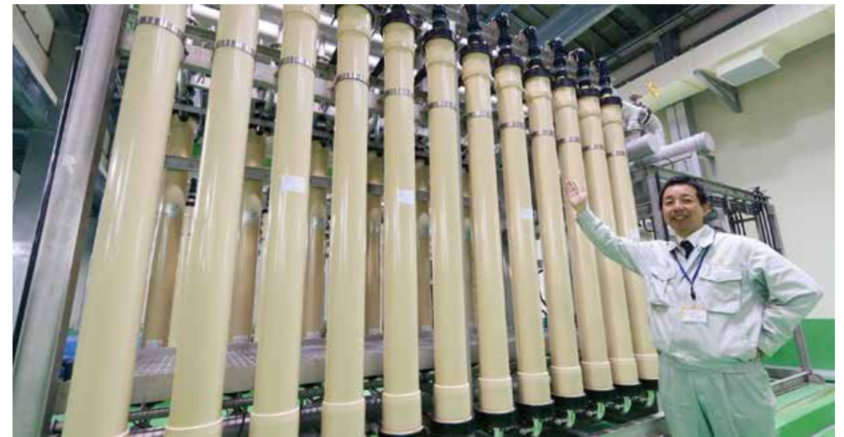
船木浄水場の膜ろ過装置。水の管理だけでなく、「機械が毎日正常に動くよう、機械の管理をすることも大切な仕事」。
