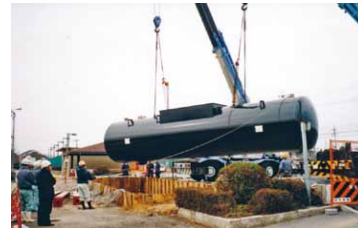
大池総合公園内に設置される耐震性貯水槽(平成9年3月)
