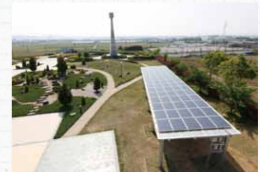
ひまわりの丘公園に設置した太陽光発電システム
