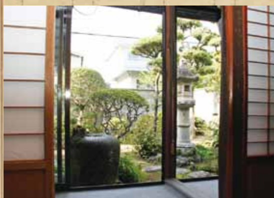
前栽に面する黒ずみのある廊下の柱
