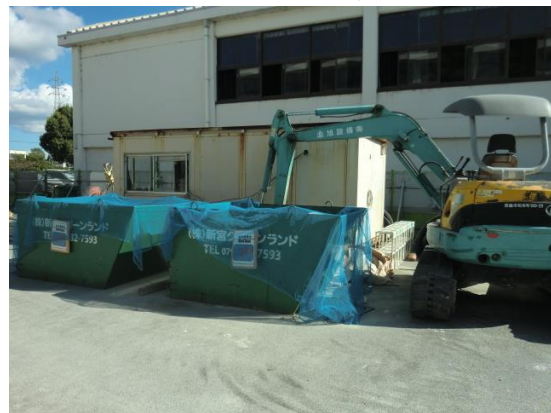
建設廃棄物集積コンテナ
